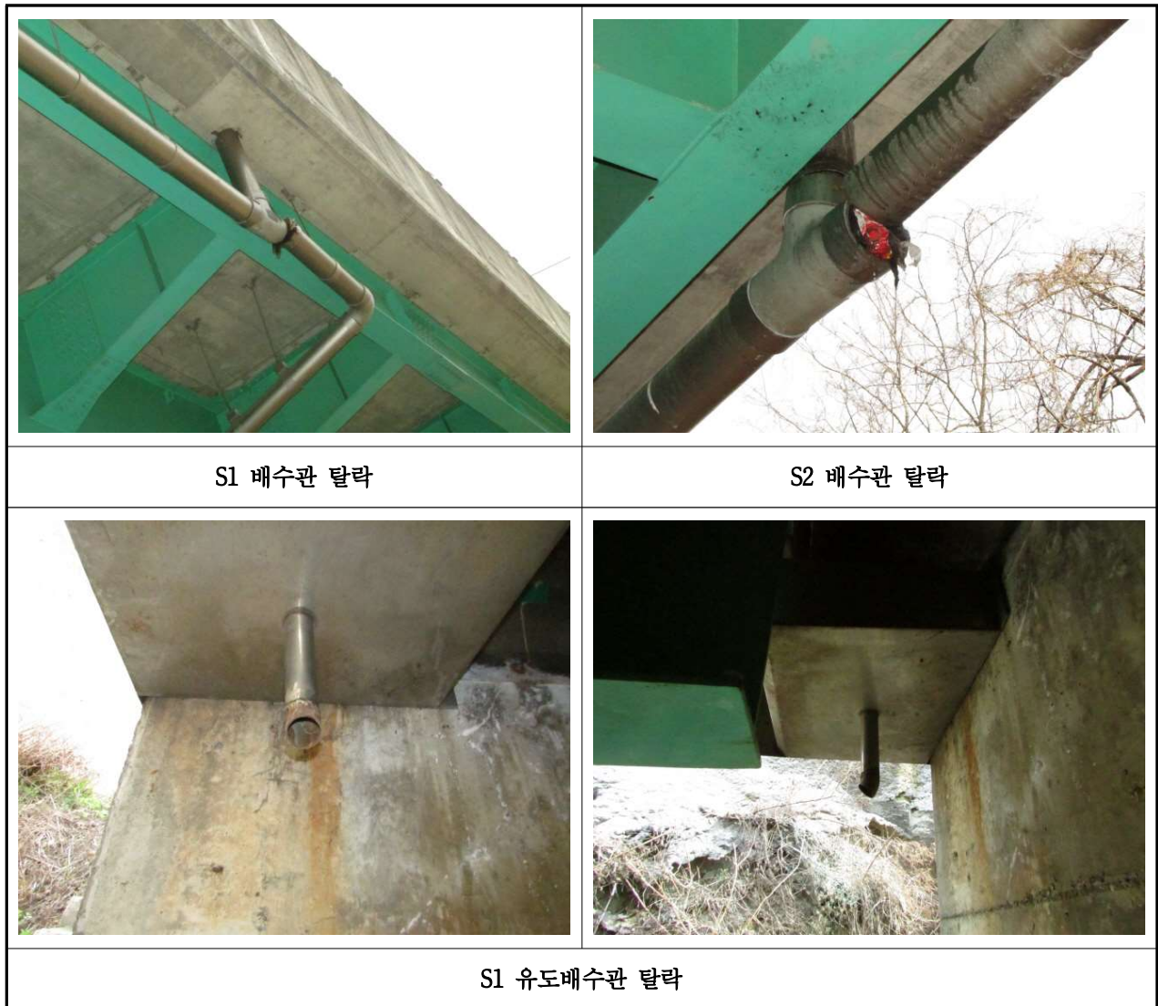
【사진 3.49】 배수시설 손상현황(울산)
