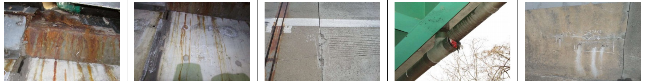
신축이음 A1 하부 철판 부식 신축이음 A2 후타재 파손 배수시설 S2 배수관 탈락 방호벽 S4 백태
