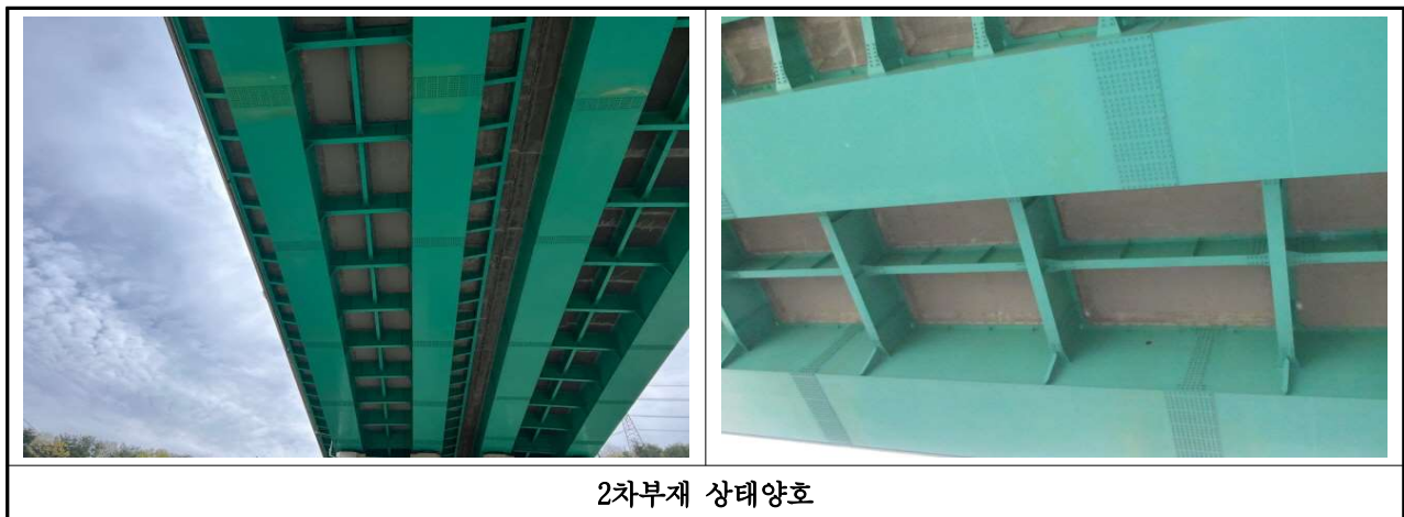
【사진 3.35】 2차부재(가로보, 세로보, 브라켓) 손상현황(울산)
