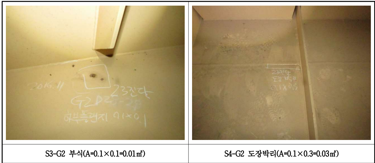
【사진 3.8】 강박스 거더 내부 손상현황(부산)
